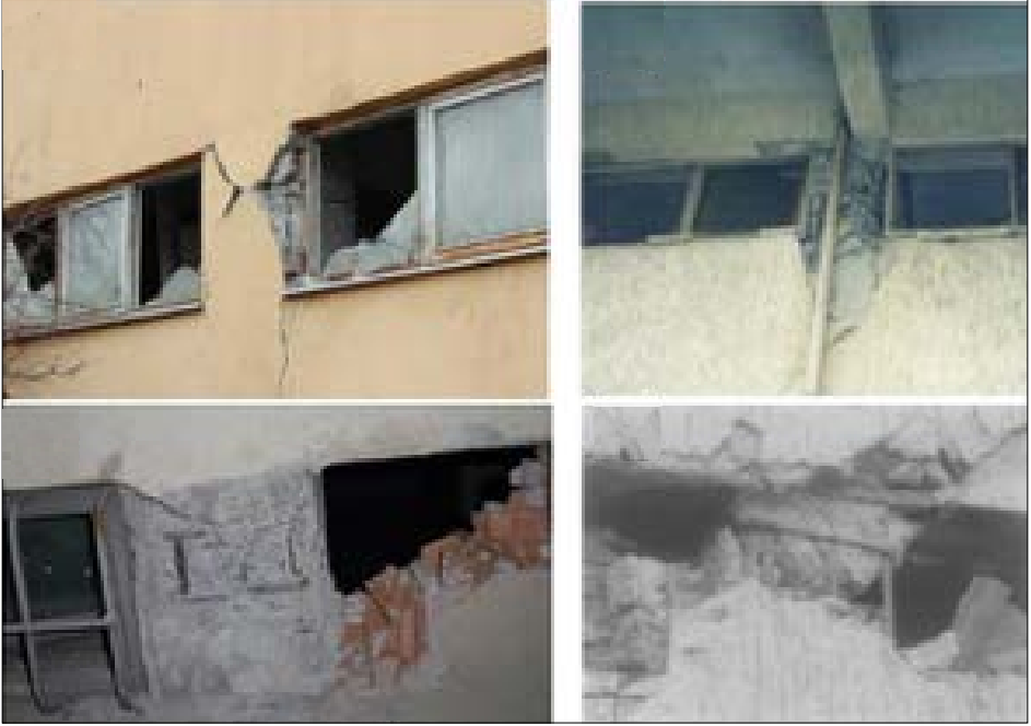
Şekil 85. Sivrice depremi sonrası hasarlar (Sivrice Belediyesi, t.y.)
