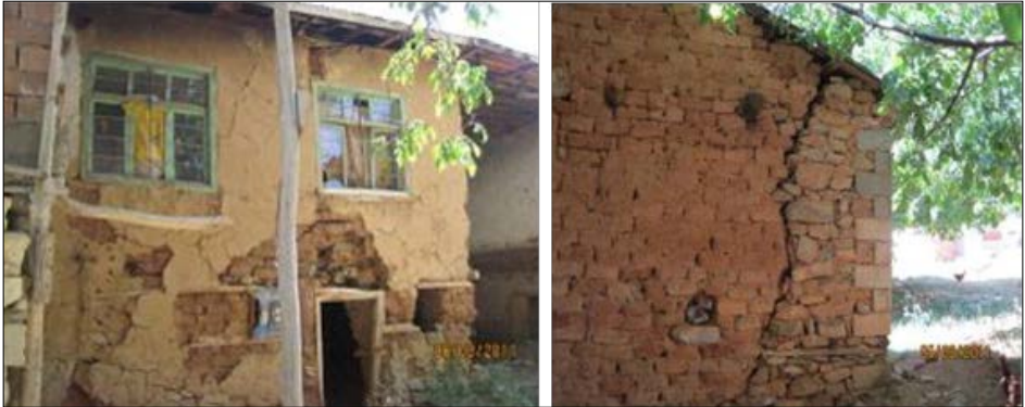
Şekil 82. Sivrice'deki bazı binaların hasarlı tuğla duvarları (Sivrice Belediyesi, t.y.)
